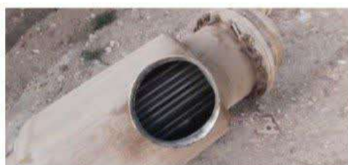
لوله های استیل داخل مبدل
